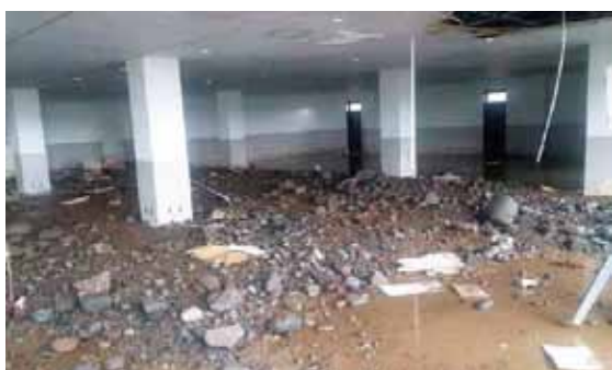
▲施設被害状況（内観）
